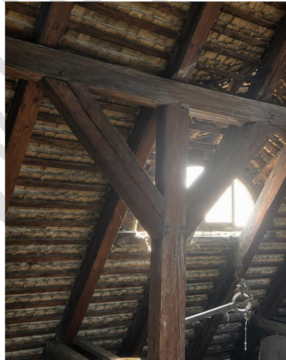
Abbildung 4: Sanierungsbedarf Dachstuhl Rathaus (Quelle: Stadt Dommitzsch)
