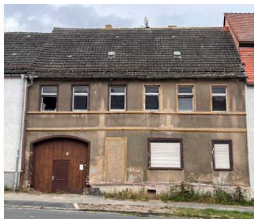
Abbildung 3: Zustandsmängel Pretzcher Str. 17 (Quelle: WHS)
