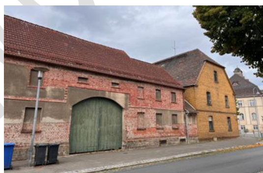
Abbildung 16: Sanierungsbedarf Torgauer Str. 43/ Leipziger Str. 1 (Denkmal) (Quelle: WHS)
